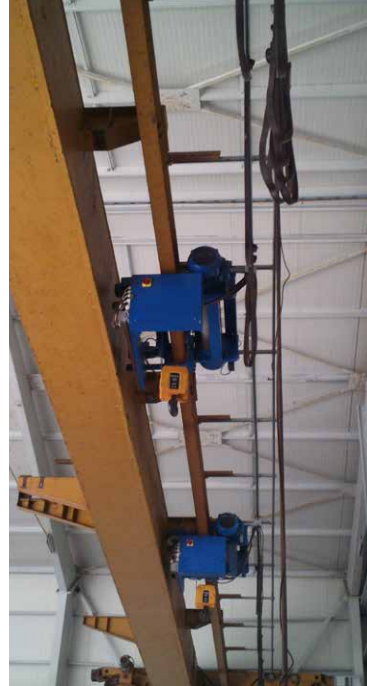
Impianto di zincatura - Galvanizing plant
