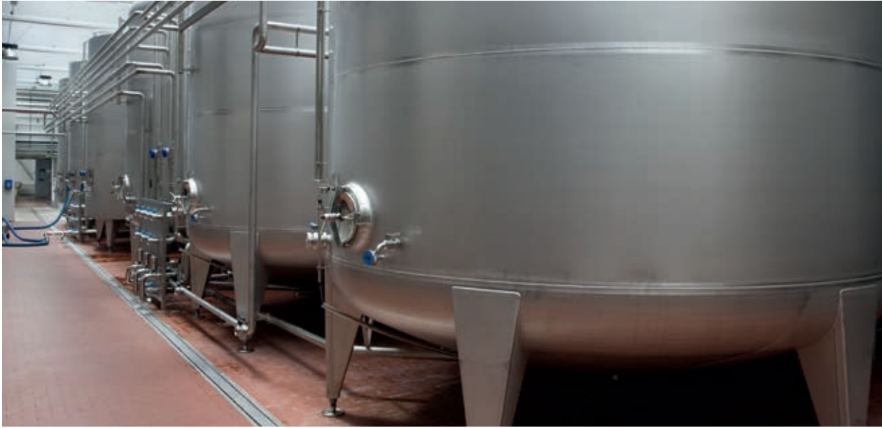
Surveillance de la conductivité pour le contrôle du produit chez un fabricant de boissons rafraîchissantes sans alcool
