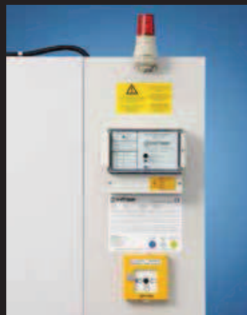
Automatische Feuerlöschanlage (Option)
