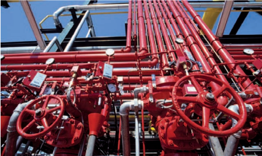
Systèmes industriels de pompage : exemple d'application des variateurs de fréquence FR-F700
