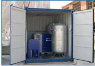
STAZIONE DI POMPAGGIO ARIA COMPRESSA
