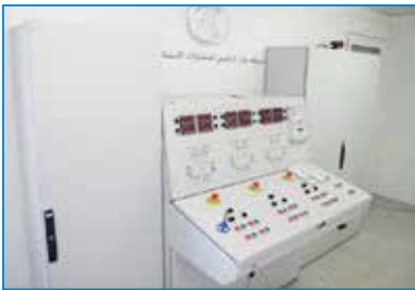
QUADRO ELETTRICO GENERALE
