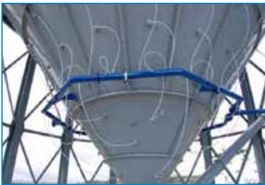
SISTEMA DI FLUIDIFICAZIONE SUL CONO DI USCITA DEL SILO AERATION SYSTEM ON SILO'S OUTLET CONE
