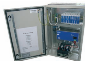
Centrale électrique ECODIS pour le désenfumage et l'aération
