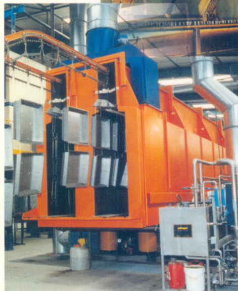
▲ FLUOLUX - Tunnel de traitements de surfaces
