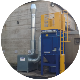
Ventilation générale et centrales de filtration
