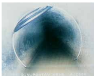
Fig. 6 - Erniatura che provoca la possibile infiltrazione di radici con conseguente pericoloso danneggiamento della funzionalità idraulica della condotta.
