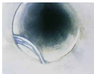
Fig. 5 - Erniatura che provoca la fuoriuscita del liquido trasportato (pericolo di inquinamento dell'ambiente) e anomala sedimentazione dalla fase solida dei liquami con conseguente variazione delle condotte idrauliche.
