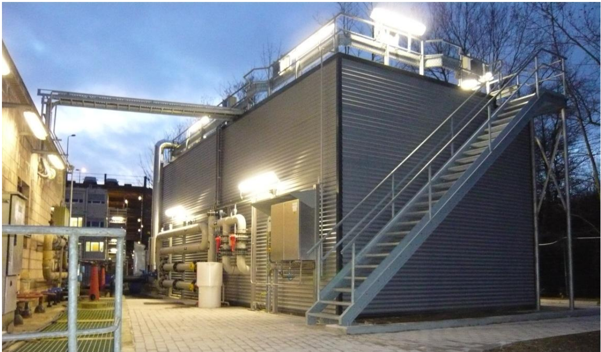
Vue générale de la station de neutralisation : 2 lignes parallèles fonctionnant en alternance
