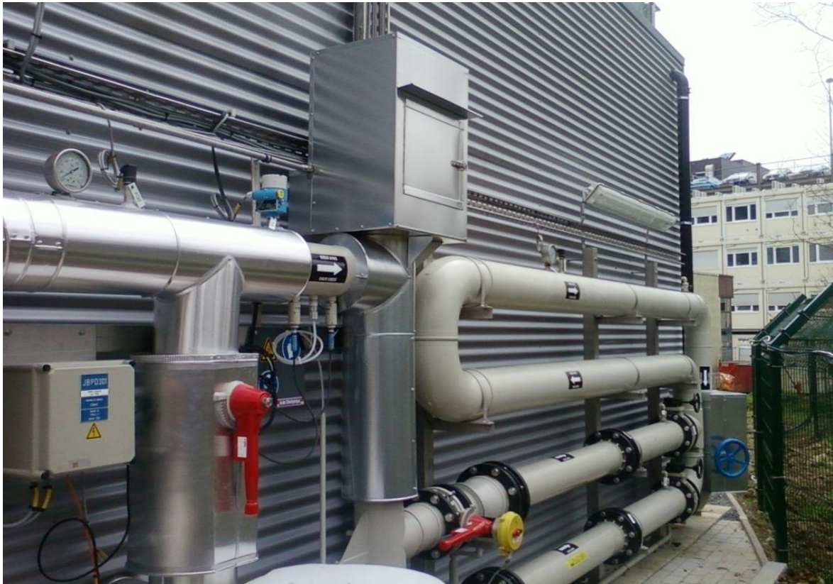
Détail de la boucle d'injection de CO 2 avec 2 sondes de pH pour la régulation du dosage et la tuyauterie sous pression avec mélangeur statique pour assurer la mise en solution du CO 2
