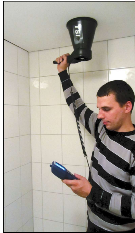
Messung am Deckenauslass
