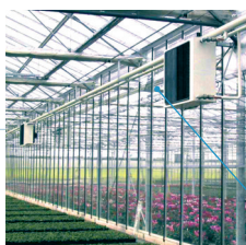
Aérothermes, eau chaude
