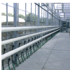
Chauffage au sol
