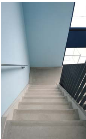
Une structure antidérapante importe autant pour les escaliers extérieurs que pour les escaliers intérieurs
