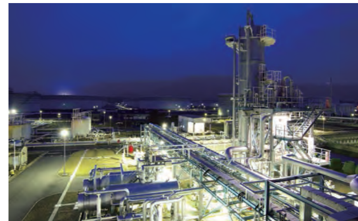
◇ Tanker VOC recovery system (Kagoshima Pref.)
