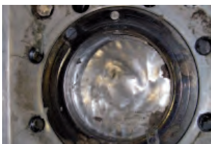
Verschleiß der Schieberplatte
