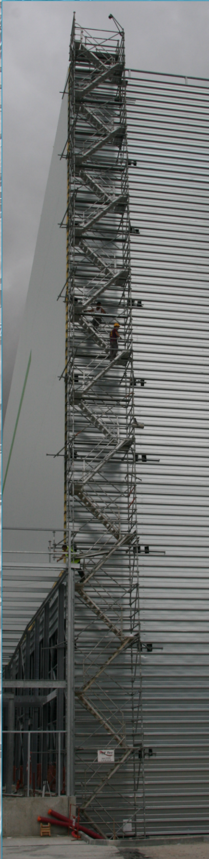
Tour escalier à volées aluminium
