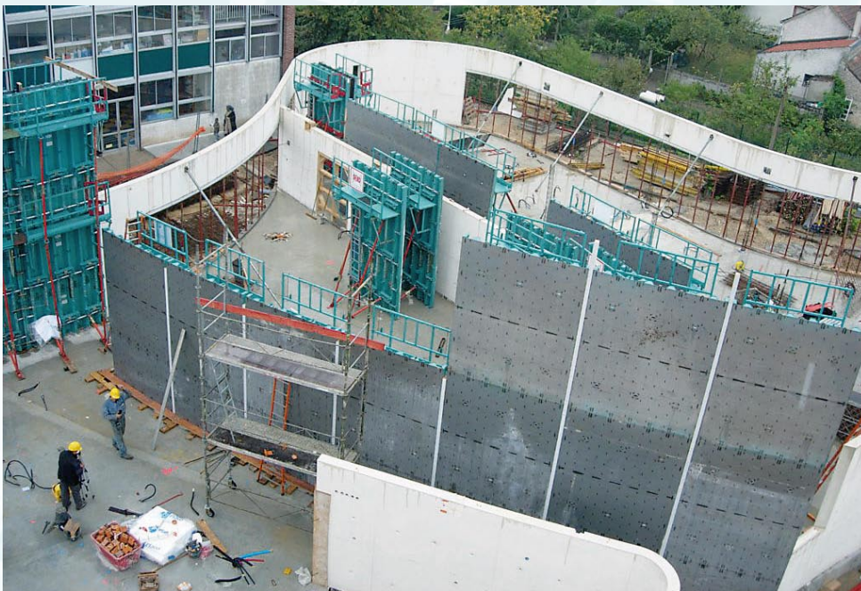
Réalisation de voiles à rayons multiples en béton blanc autoplaçant pour groupe scolaire.
