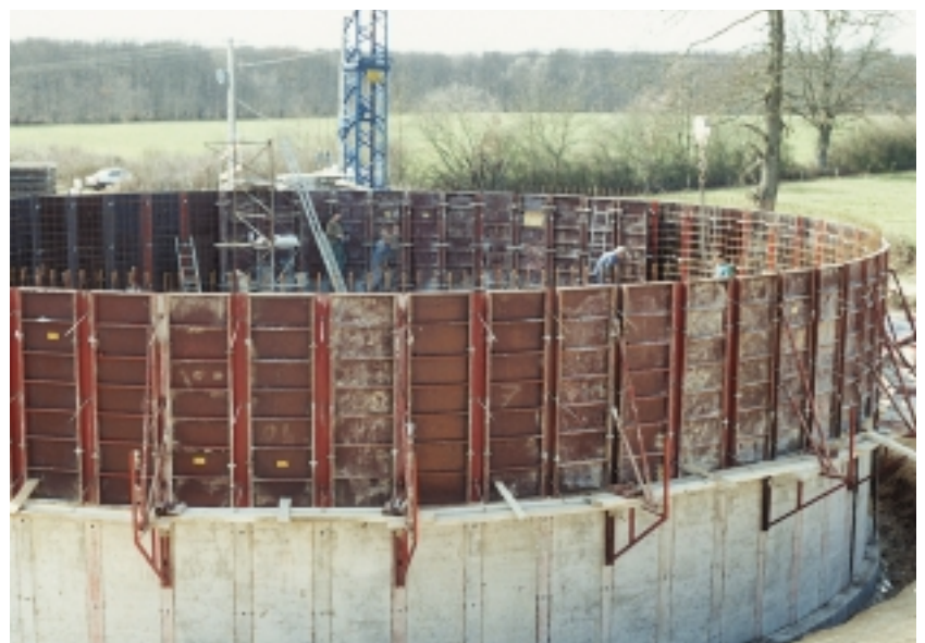
Bassin circulaire (Entreprise Novello)
