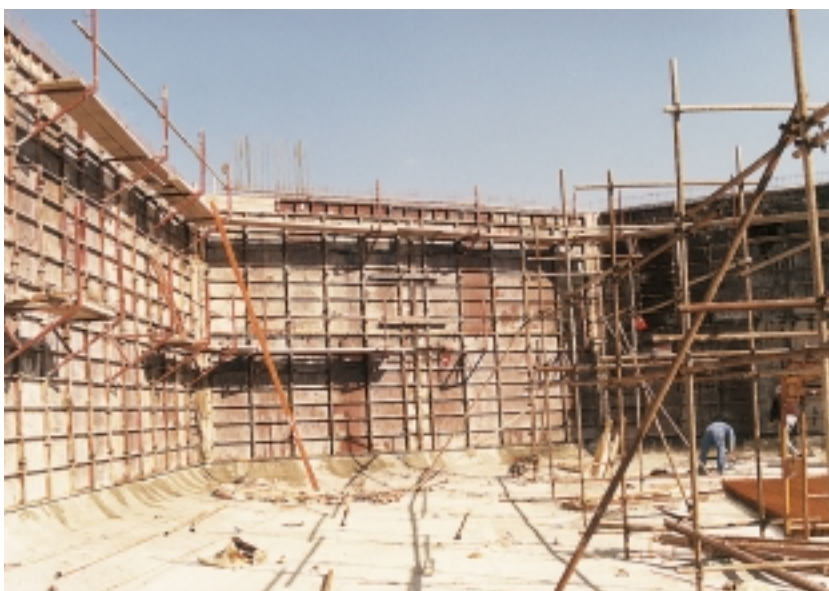
Réservoir d'eau potable
