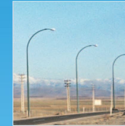
Lighting poles Candélabres d'éclairage
