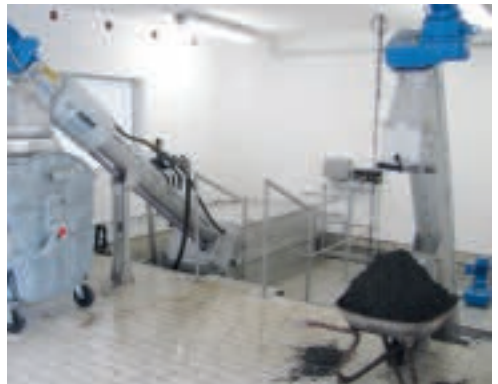
Laveur de sables intégré dans le dessableur
