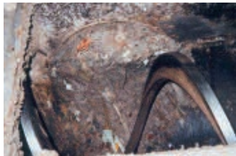
Refus avant traitement
