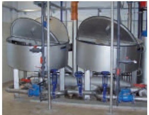
Installation de deux unités en parallèle sur des STEP jusqu'à 200 000 EH.
