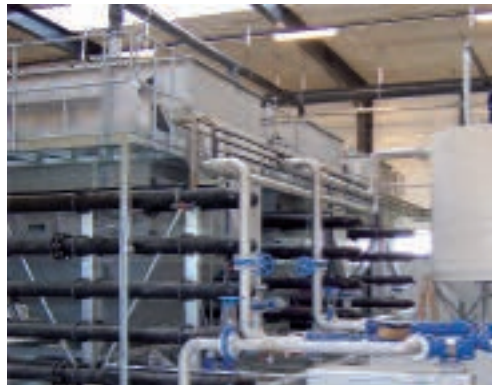
Flottateur à air dissous HUBER HDF comprenant une phase de conditionnement chimique
