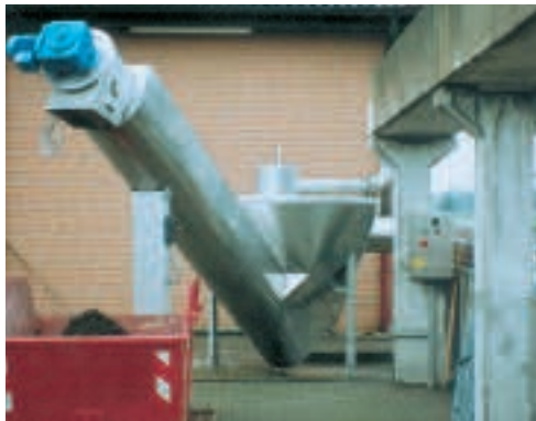
Classificateur à sable COANDA installé après le dessableur
