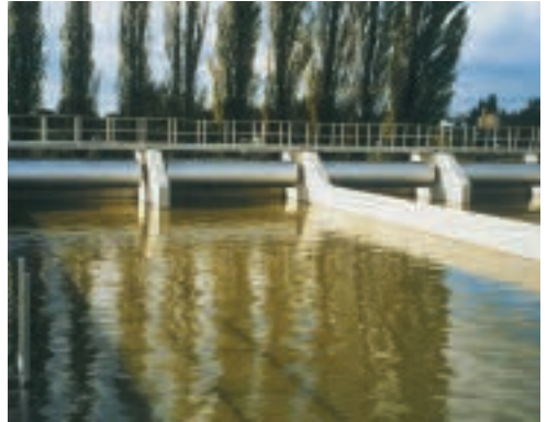
Flots de rincage puissants et constants même sur les longs bassins
