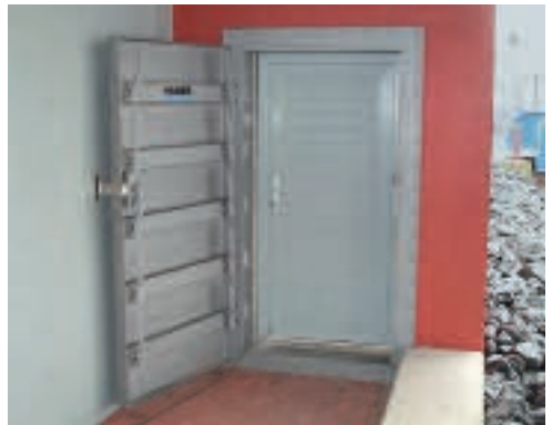
Porte étanche à la crue
