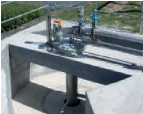
Dessableur circulaire Vortex HUBER VORMAX avant mise en service
