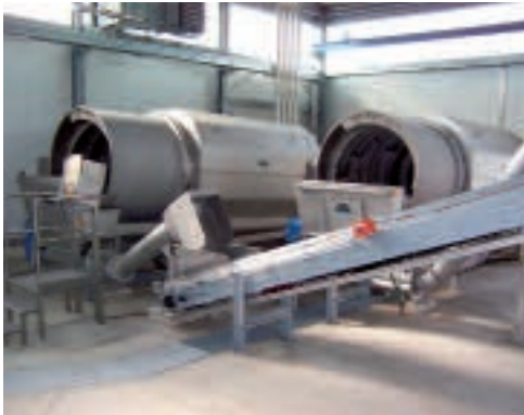
Système de criblage des sables contaminés
