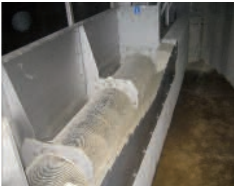
Mesure du volume déchargé avec le tamiseur ROTAMAT® RoK 2 et une mesure de lame de surverse
