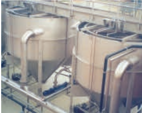
Dessableur circulaire ROTAMAT® HRSF en fonctionnement
