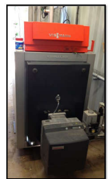
Réseau de chaleur
