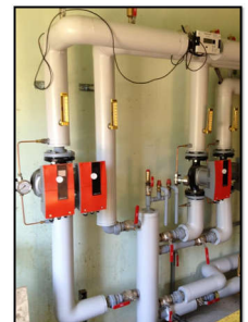
Station de distribution de la chaleur
