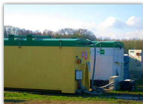
2 digesteurs de 30m 3 « ERibox »
