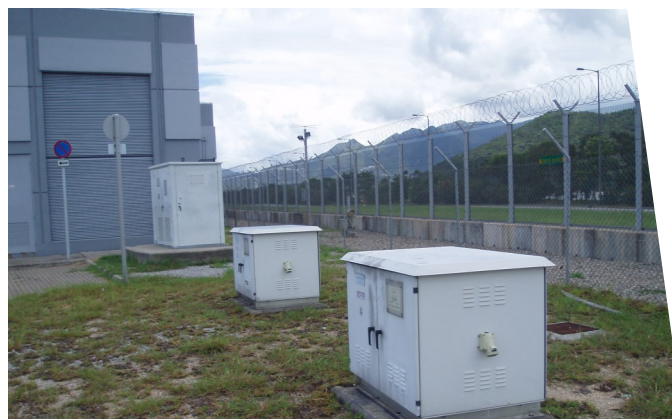
Aéroport de Hong Kong, éclairage clôture
