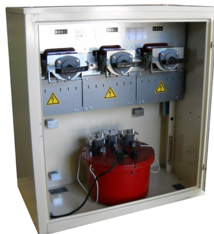
PT3I ext avec transformateur 5 kVA
