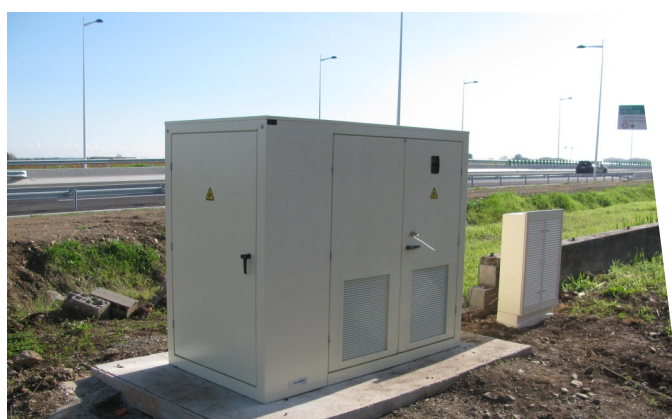
Rocade de Borgo, alimentation de l'éclairage
