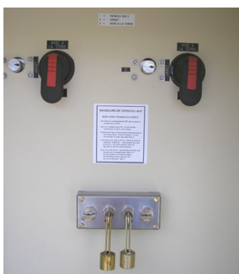
Interrupteurs 950 V + verrouillage
