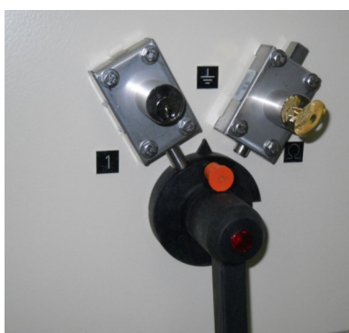
Commutateur d'isolement et de mise à la terre CIMALT et verrouillage
