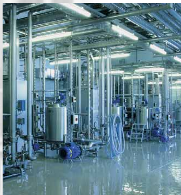
Contrôle de pression dans les zones aseptiques.
