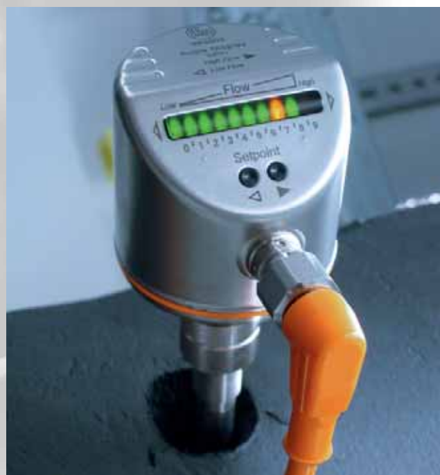
Surveillance du débit dans une conduite de retour d'un grand diamètre nominal.
