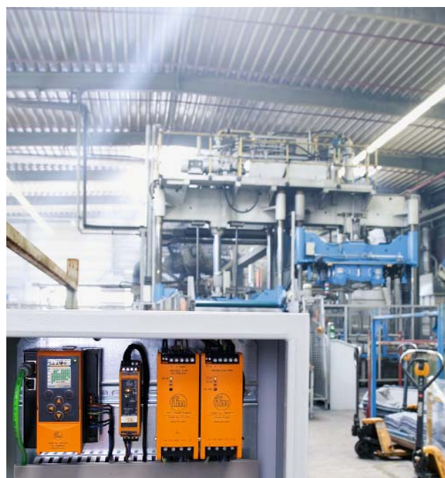
Passerelle AS-i dans une armoire électrique décentralisée.
