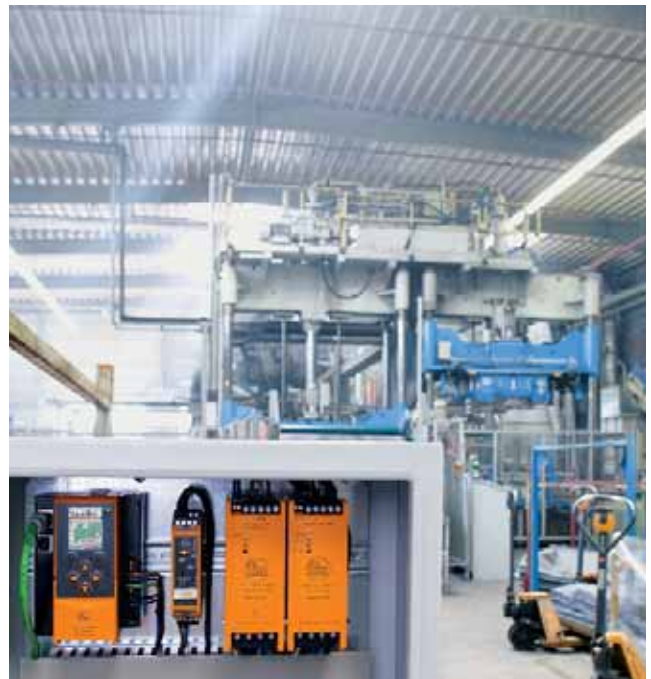
Passerelle AS-i dans une armoire électrique décentralisée.
