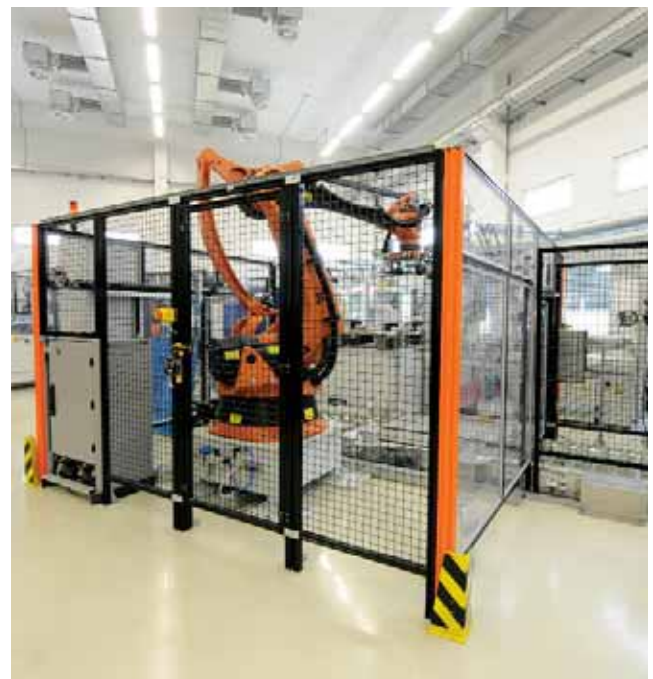
Porte avec interrupteur de sécurité et interverrouillage.
