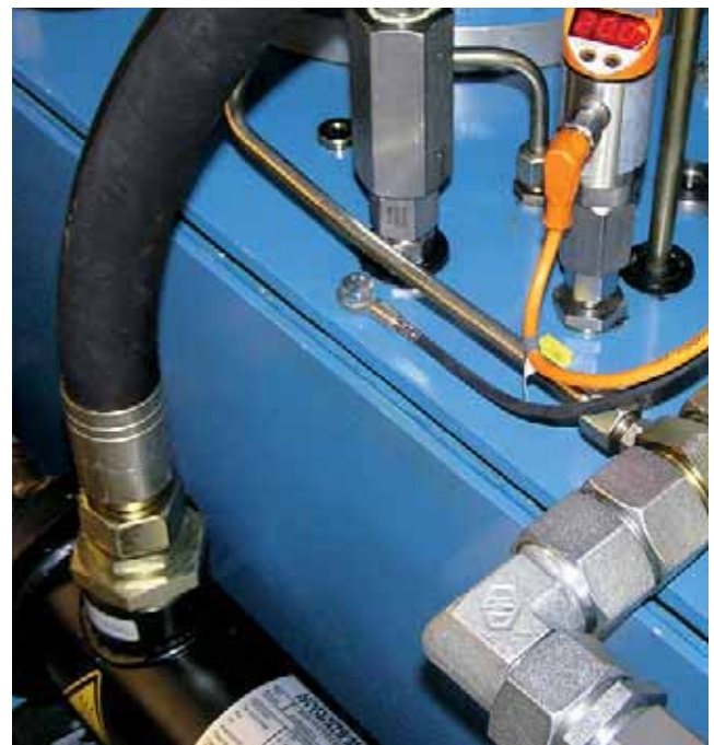
Capteur de température Pt100 installé sur une citerne à fuel pour surveiller la température de la paroi.
