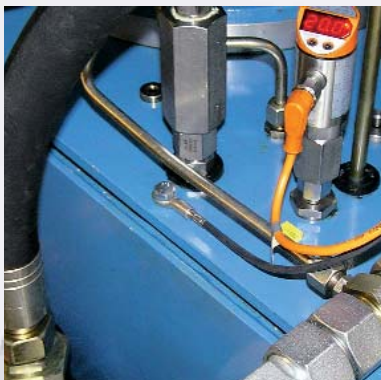
Instrumentation des groupes hydrauliques (température, pression, niveau, débit)
