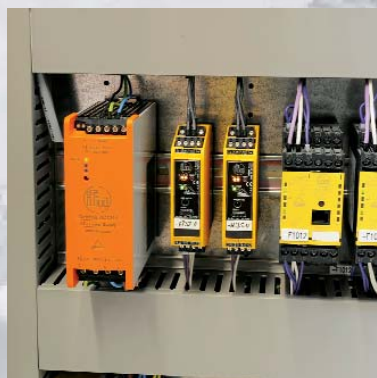
Gestion de la sécurité sur AS-i Safety
